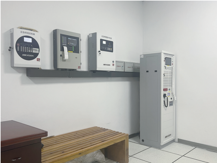
应急照明、火灾报警和消防联控控制系统
